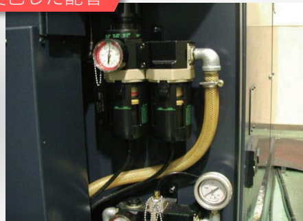
変色した配管
